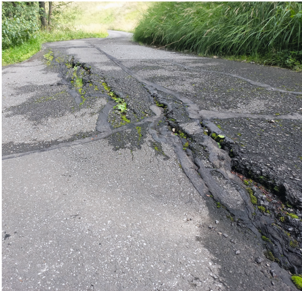
Schadstellen an der Schwanderbärglistrasse
