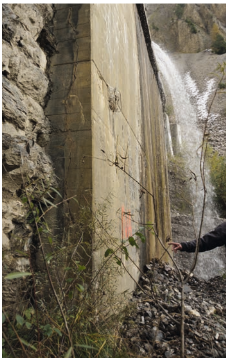
Detail der gerissenen Betonplatte bei Sperre IVa
