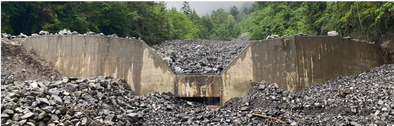
Überfüllter Geschiebesammler Oberer Bachtalen
