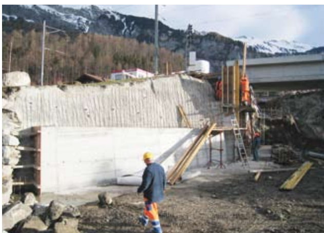
Ende Februar war die erste Etappe der seeseitigen Flügelmauern Seite Brienz fertig betoniert.
