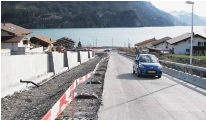
Das Bild vom März 2010 hat bereits historischen Charakter: Seit Mai fliesst der Verkehr über die neue Schwanderstrasse; der Rückbau der alten Schwanderstrasse hat begonnen.
